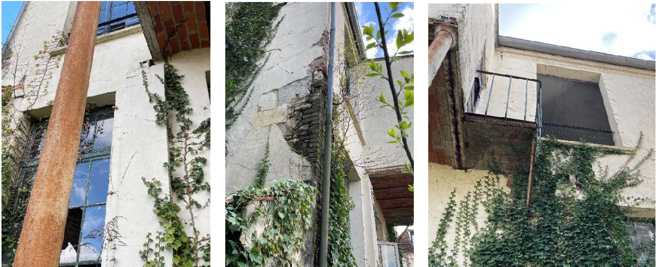
Photographies de murs fissurés en façade sur cour arrière du lot 02
