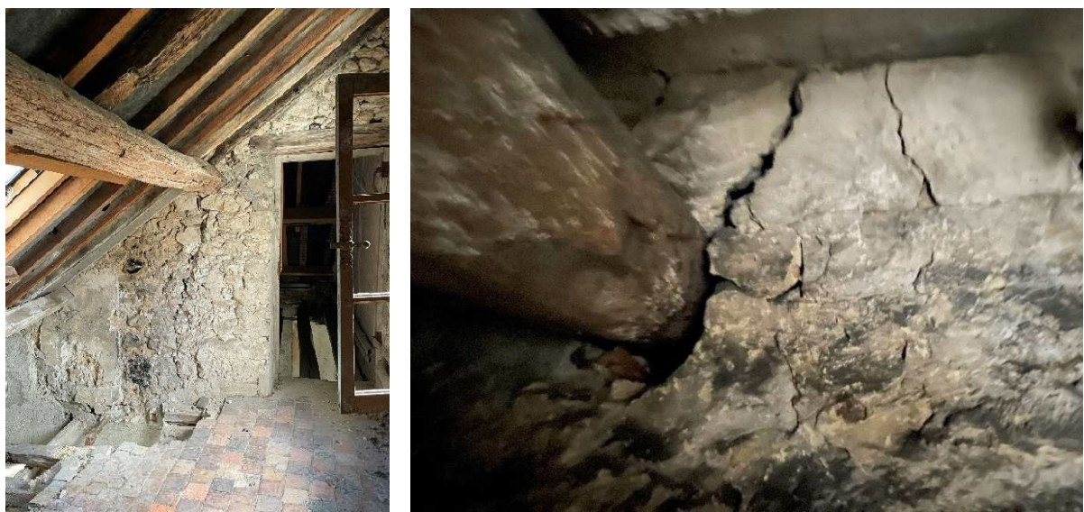
Photographies de fissures en intérieur de bâtiments au droit d'appuis de poutres bois
