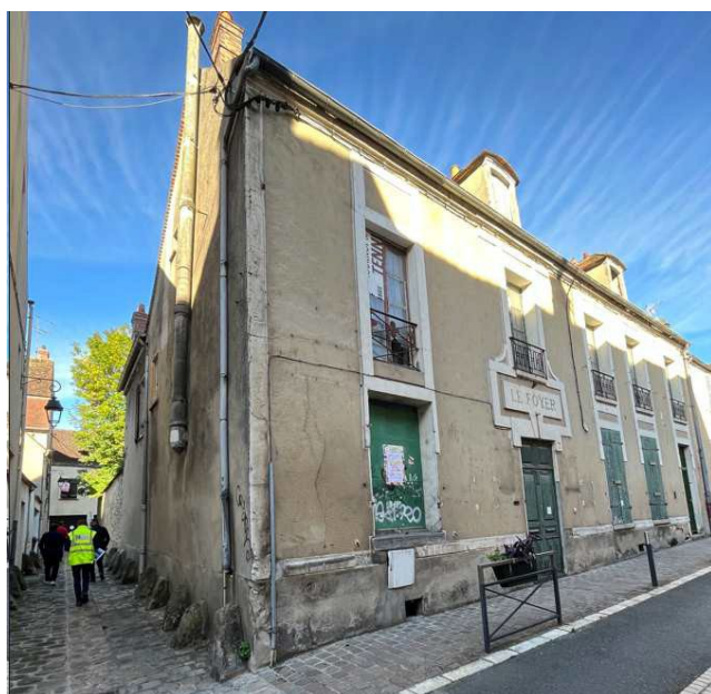
Photographie de la façade du lot 1 en mauvais état sur rue du Dr Dumée
