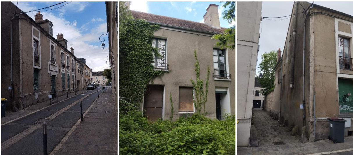
Figure 12 - Vues sur le bâtiment dit du Foyer Dumée, dont l'état de la structure est compromis (photos : commune de Nemours)
