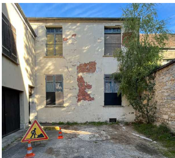
Photographie de la façade arrière du lot 1 en mauvais état sur rue de la Bredauche
