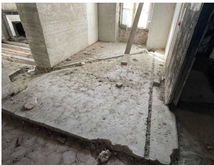
Photographies des sols en place en mauvais état
