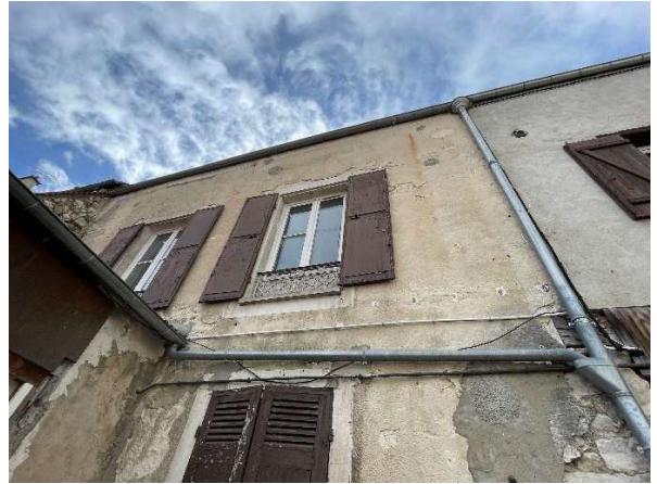
Photographie de la façade arrière sur cour du lot 2 en mauvais état
