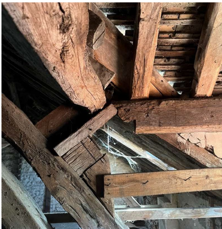
Photographie locale des charpentes ne respectant pas les règles de construction
