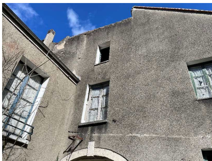
Photographie de la façade arrière du lot 1 en mauvais état sur cour intérieure
