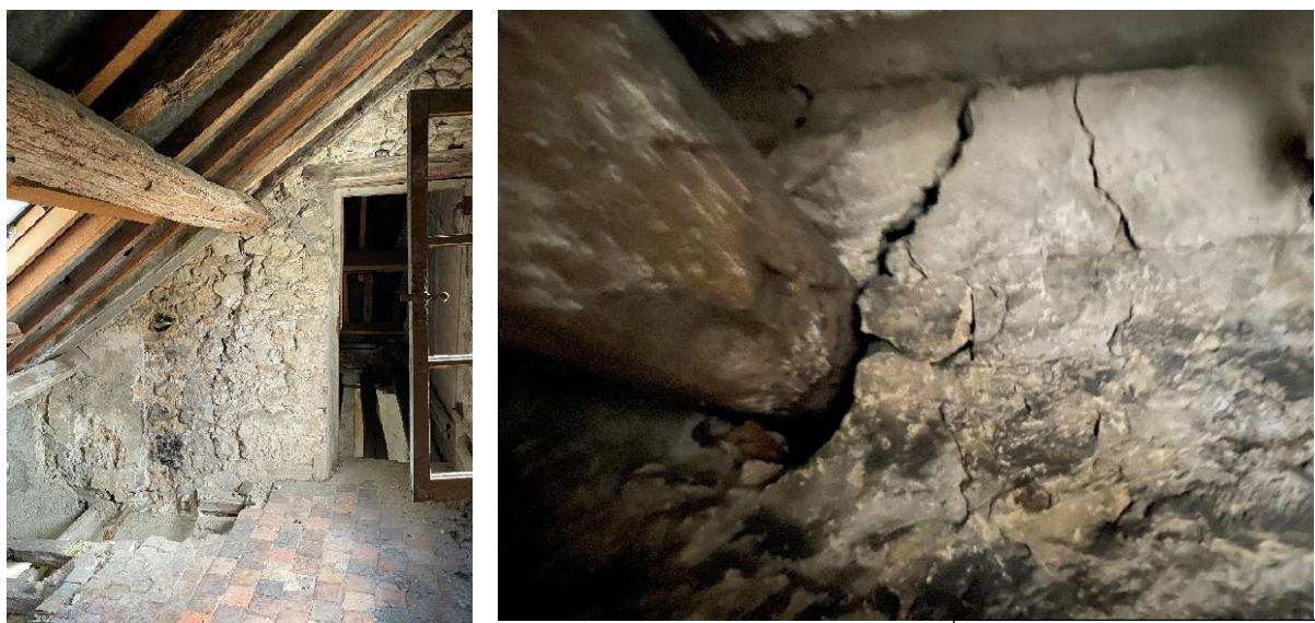
Photographies de fissures en intérieur de bâtiments au droit d'appuis de poutres en bois
