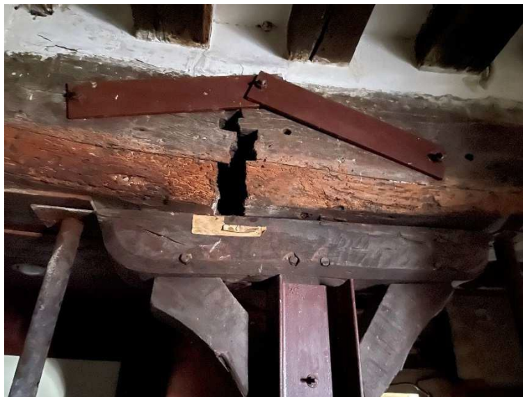
Photographie d'une poutre principale cassée et étayée provisoirement
