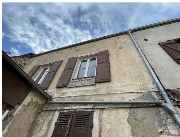
Photographie de la façade arrière sur cour du lot 2 en mauvais état
