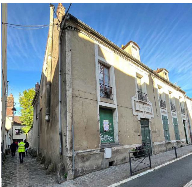
Photographie de la façade du lot 1 en mauvais état sur rue du Dr Dumée
