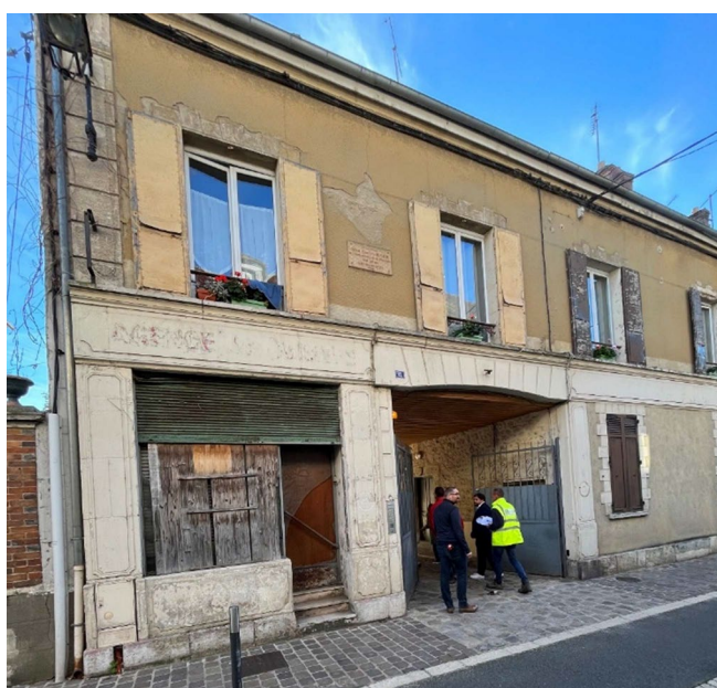
Photographie de la façade du lot 2 en mauvais état sur rue du Dr Dumée
