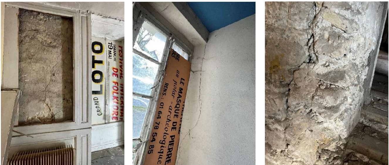
Photographies de murs fissurés en intérieur de bâtiments
