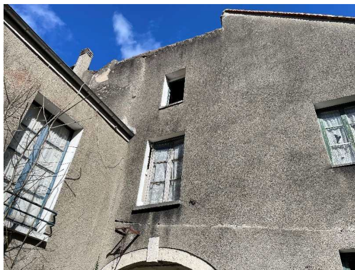
Photographie de la façade arrière du lot 1 en mauvais état sur cour intérieure
