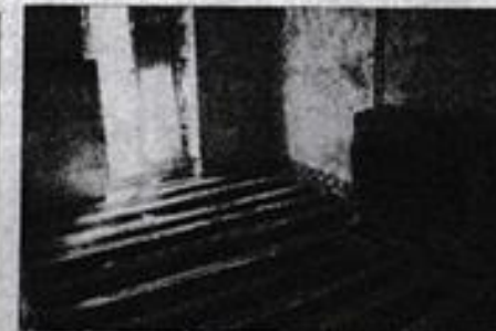
Les murs de pierres bétonnés lors d'anciennes rénovations empêchent de mesurer l'état réel de la structure.
